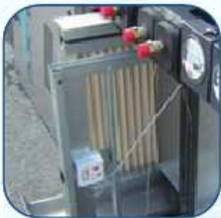
Protimrazová ochrana výměníku. Namontována ve zvláštním rámu.
